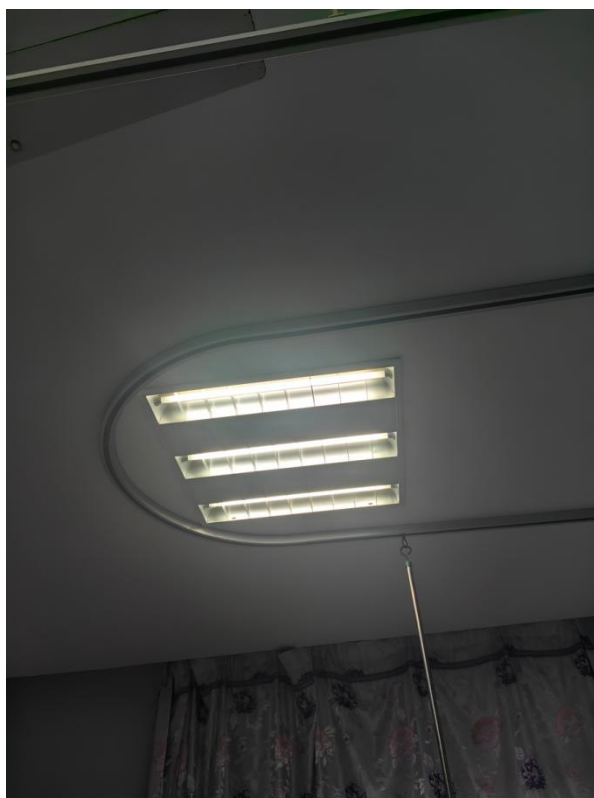
图 14 二号楼病房 0.6m T5 荧光灯
