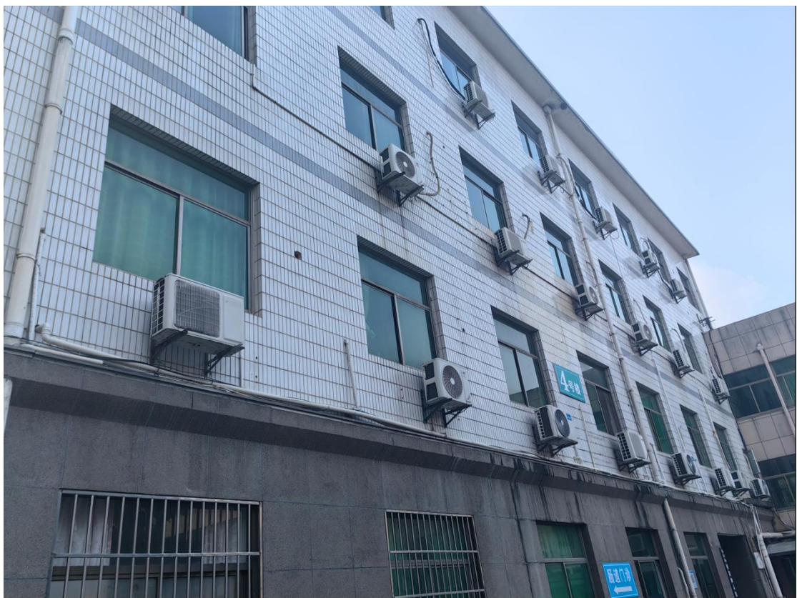
图 30 四号楼分体式空调
