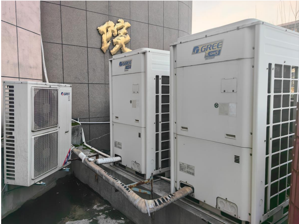
图 17 一号楼变频多联式空调室外机
