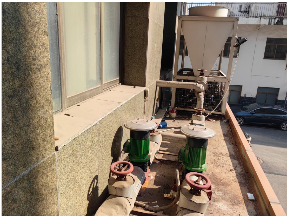
图 26 风冷热泵机组及水泵
