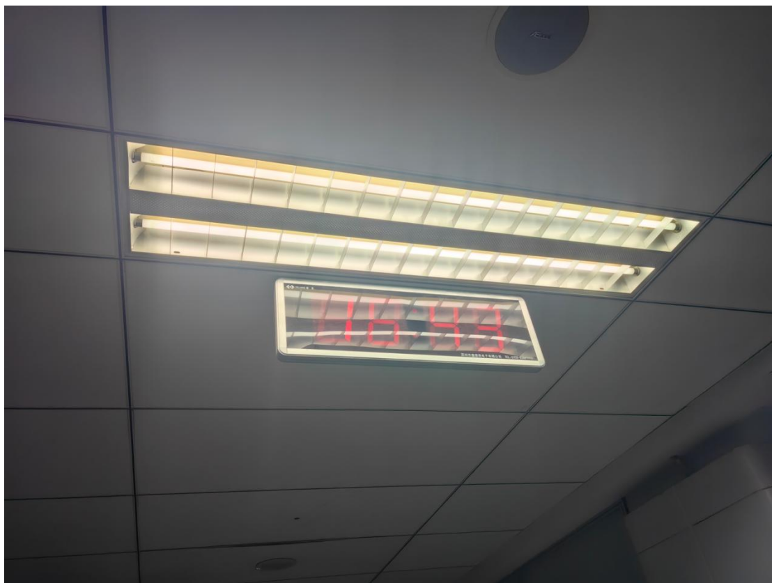
图 15 二号楼走廊 1.2m T5 荧光灯
