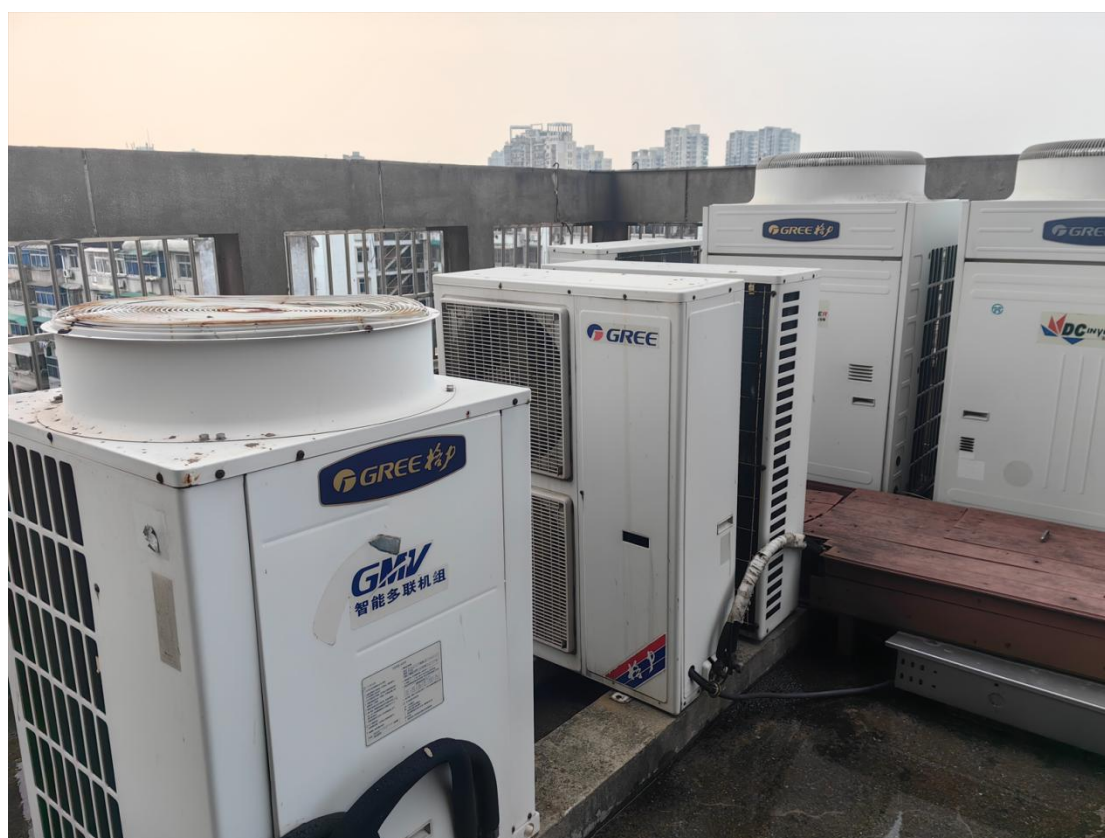
图 23 楼顶多联式空调室外机
