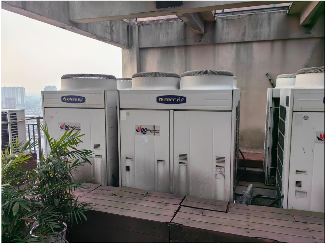
图 24 楼顶多联式空调室外机
