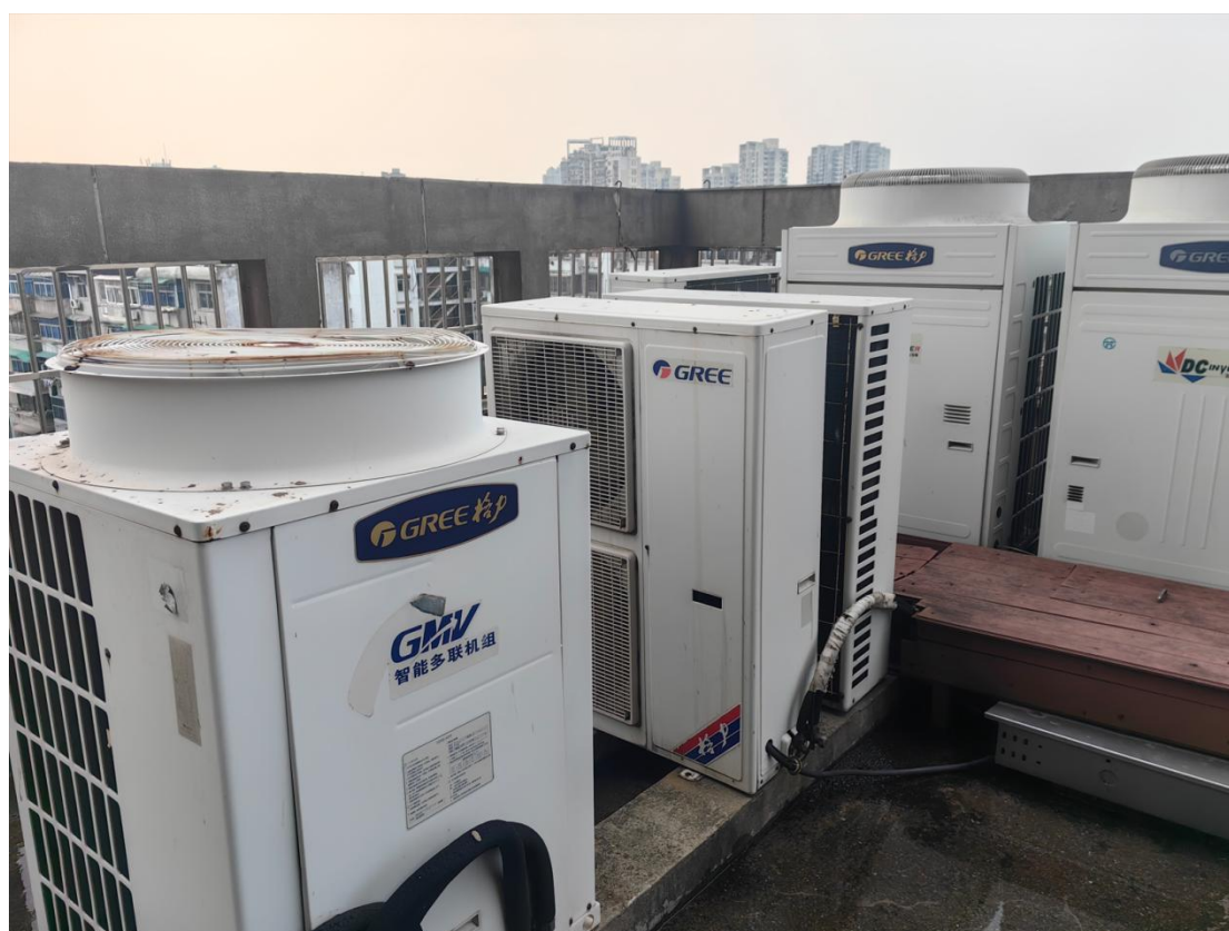
图 23 楼顶多联式空调室外机
