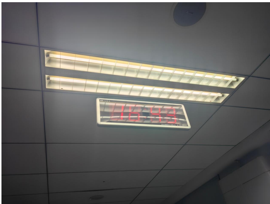
图 15 二号楼走廊 1.2m T5 荧光灯
