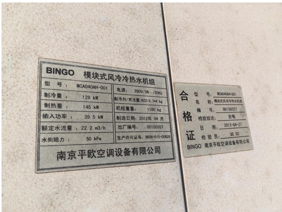
图 27 风冷热泵机组铭牌
