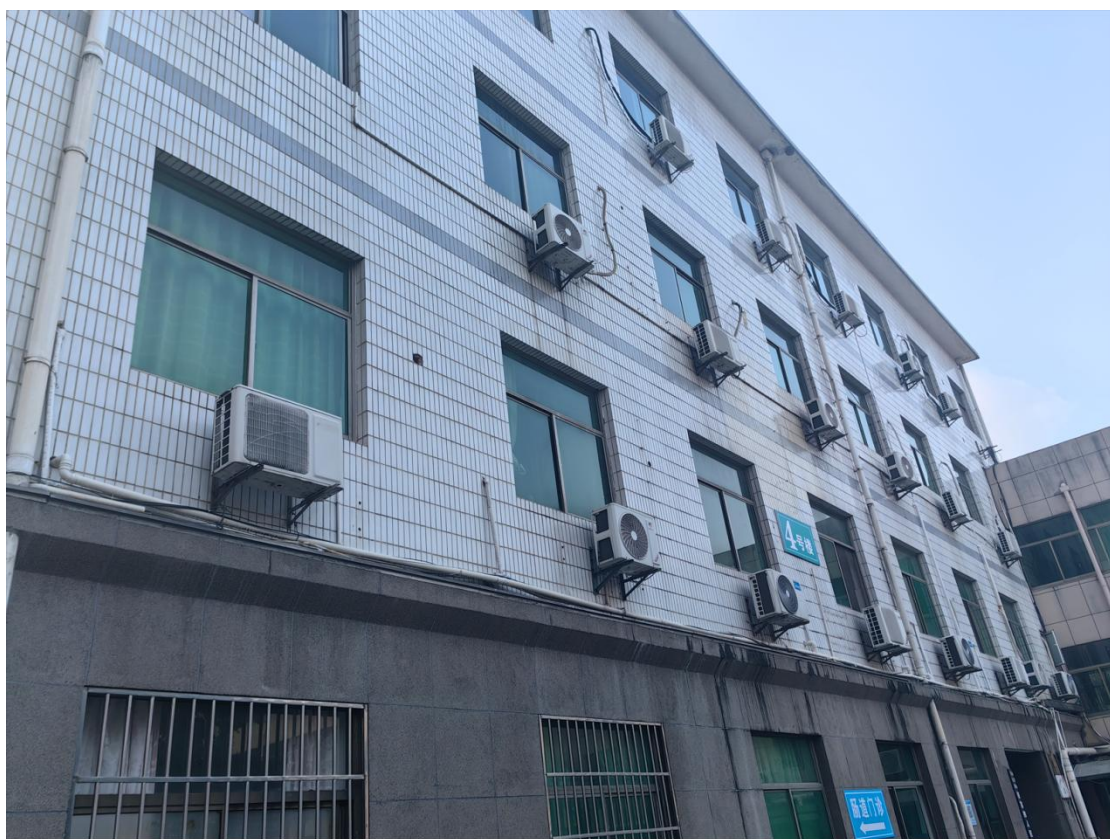
图 30 四号楼分体式空调
