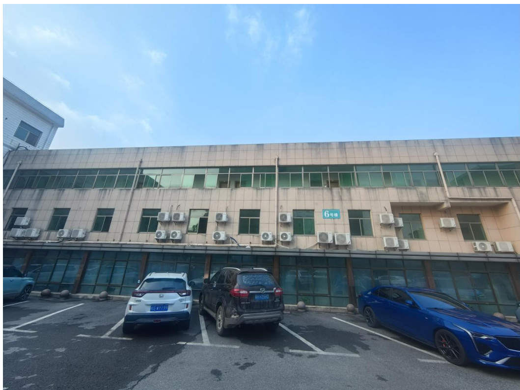
图 32 六号楼分体式空调
