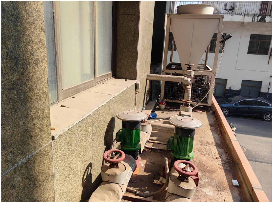
图 26 风冷热泵机组及水泵
