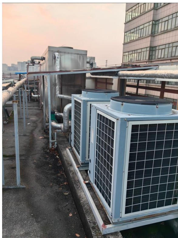
图 41 空气源热泵热水机组
